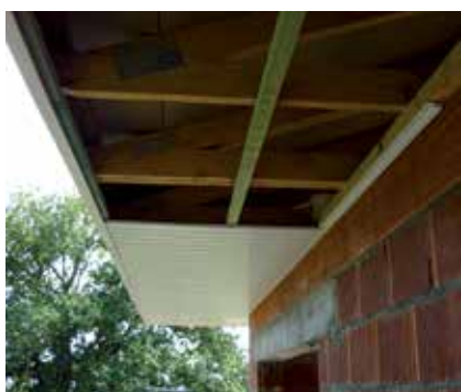
Las piezas se reciben en obra el mismo día que se van a montar
